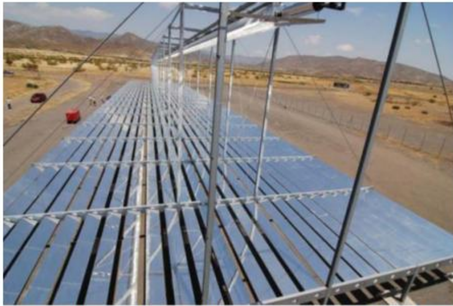
Figura 14: Concentrador Linear Fresnel na PSA (Fonte: PSA, 2015).
