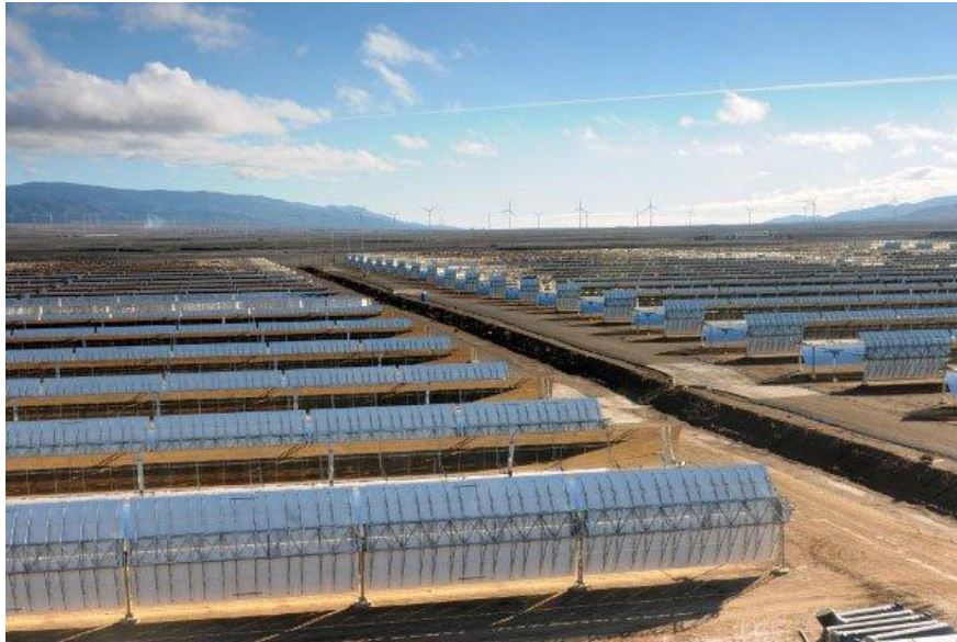
Figura 10: Planta de Energia Solar Andasol (Fonte: RWE, 2015).
